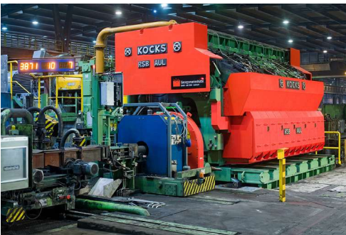
Walzwerk Oben: Kühlbett Mitte: Walzgerüst 2 Unten: RSB Block
